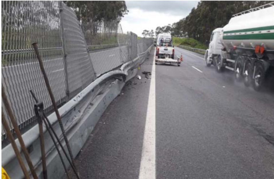
FOTO 07 - Dispositivo de Segurança – Km 44+500 Norte [1]
