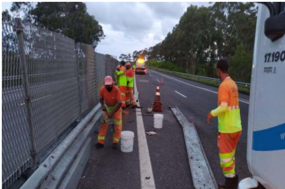
FOTO 08 - Dispositivo de Segurança – Km 44+500 Norte [2]
